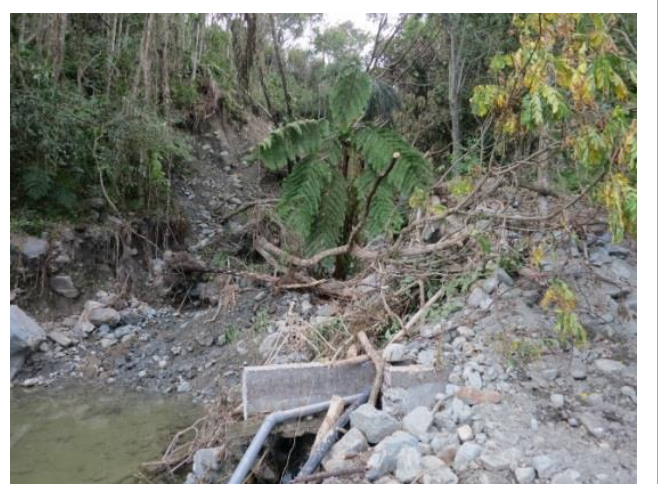
照片14: 沖毀的產業道路上方野溪兩側皆為崩積層
