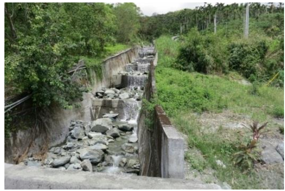
照片20：南側花縣DF030土石流潛勢溪流河床土石影響較小
