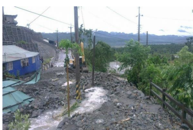
照片8：排水溝已經被掩埋約50公尺、涵洞阻塞（江子亮先生提供）
