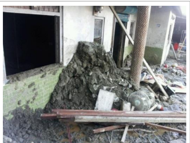
照片10: 房舍窗戶已被破壞(江子亮先生提供)
