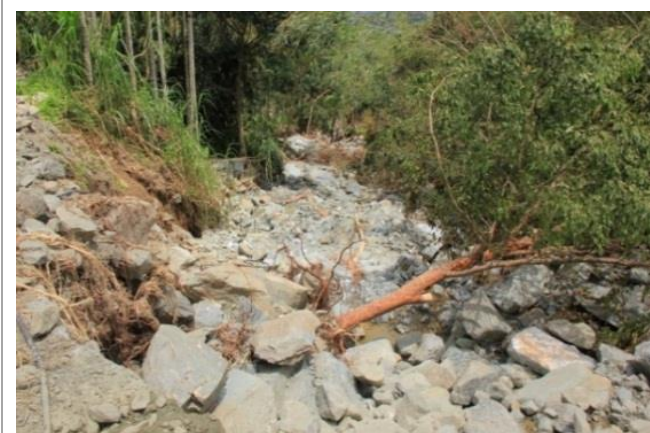
照片5：野溪上游坡面已成沖蝕溝
