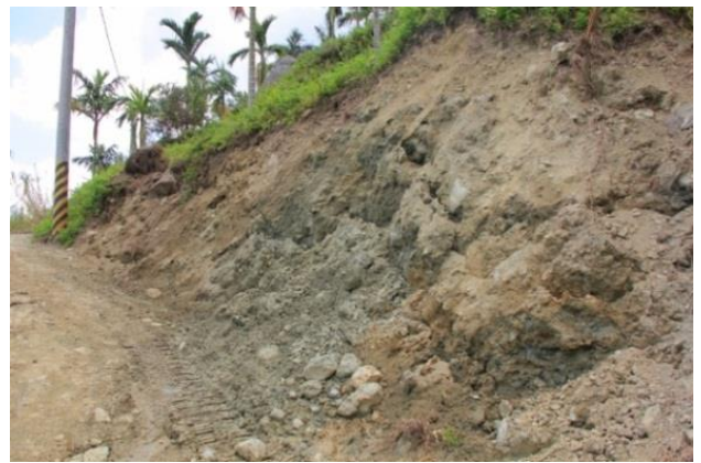
照片16：野溪上游坡面崩積層
