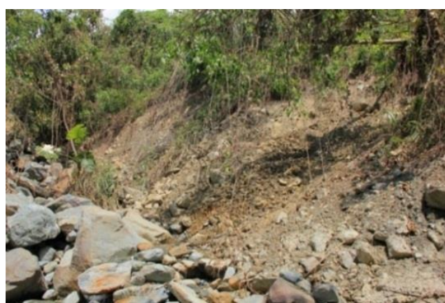
照片6：距離涵洞約70m處野溪左岸崩塌
