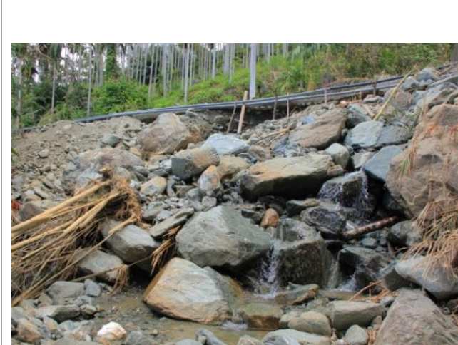
照片13: 產業道路被沖毀15m, 衝出寬8.5m蝕溝
