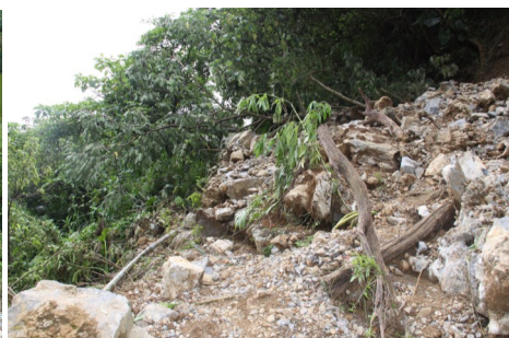
佐倉步道邊坡土石滑崩狀況
