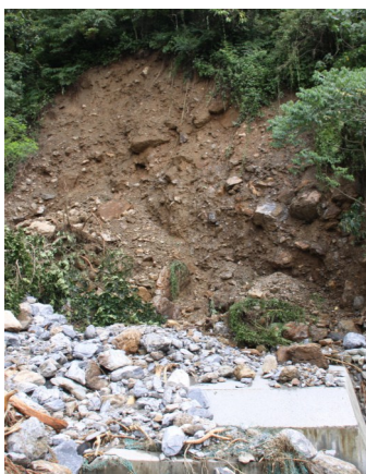
佐倉步道邊坡崩坍情形
