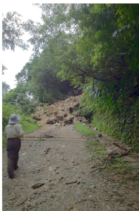
照片 5：佐倉步道部分崩坍
