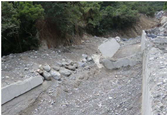
圖：和中聚落遭蘇拉颱風帶來土石掩埋野溪整治之堤防，圖為已緊急疏清後之狀況。
