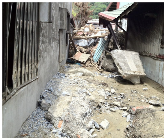
照片 1：土石大量沖入民宅
