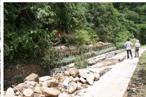
佐倉步道排水溝及砌石邊坡遭摧毀。
