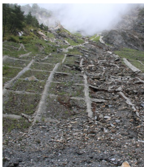
蘇拉風災中被土石沖毀的和中聚落連結外對外交通之邊坡擋土牆。
